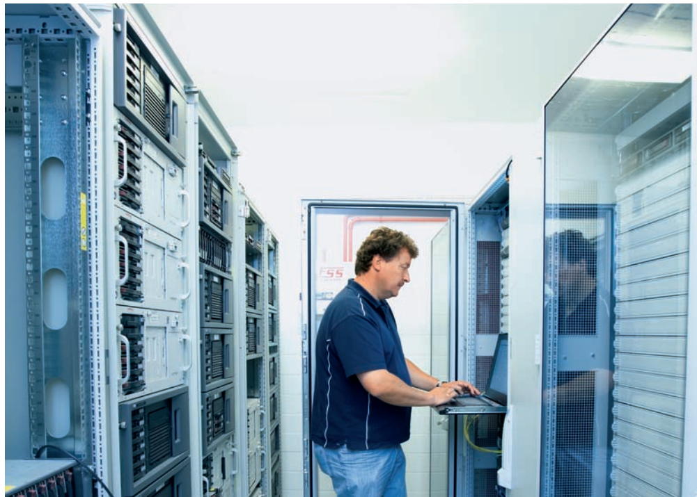
Christian Labhart, Leiter des Rechenzentrums der HINT AG, im ausgebauten Serverraum.
